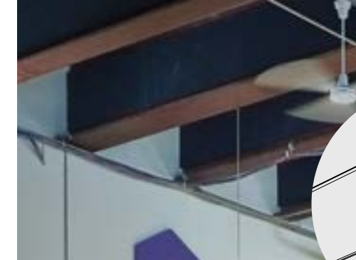
▲ Aplicación en I-Beam de InvisAcoustics; Lancaster Science Factory, Lancaster, Pensilvania
