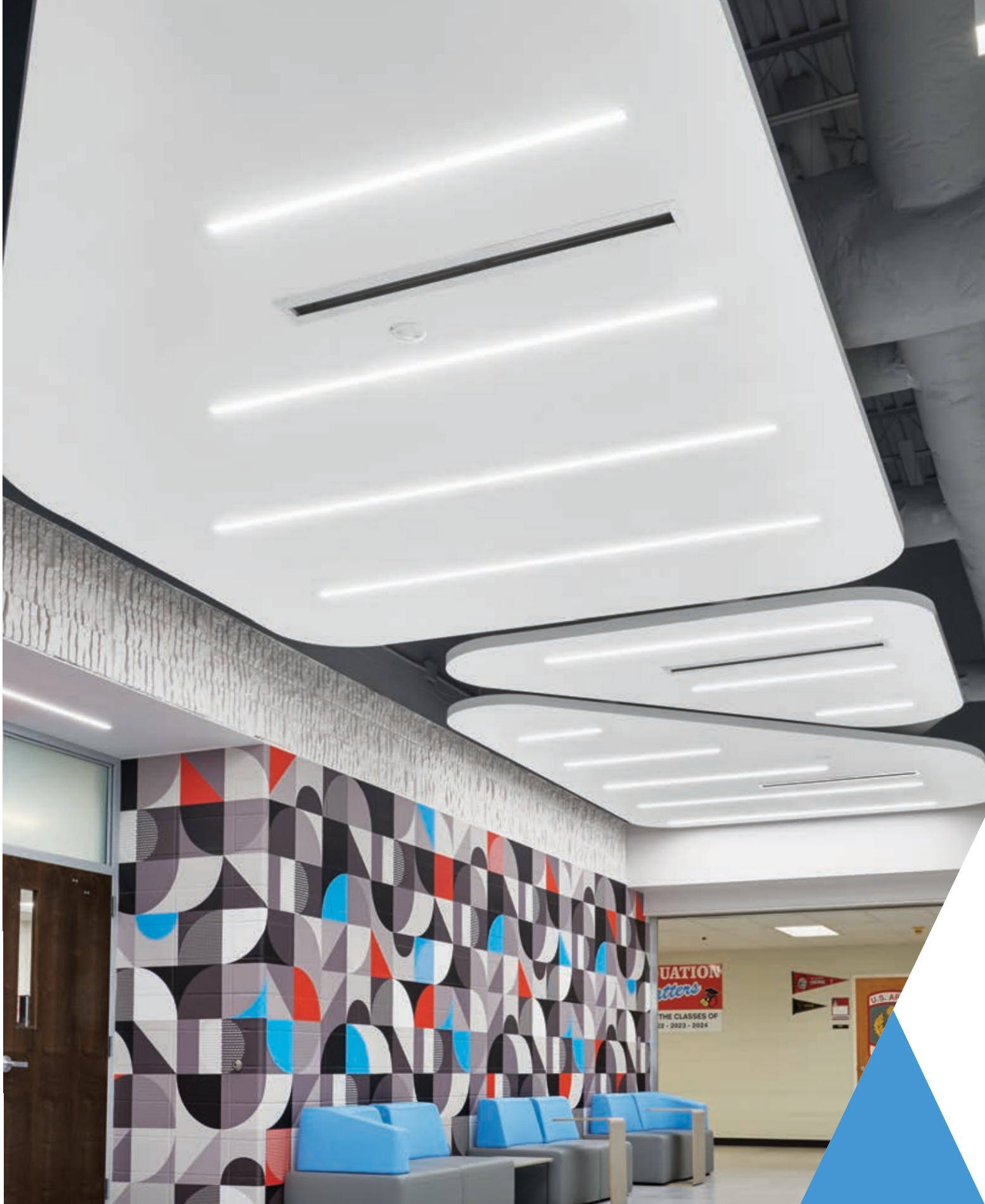
▲ Sistema de forro acústico sem emenda AcoustiBuilt®, aplicação em nuvem / Axiom® Classic Trim; Incite Design Studio; Webb City High School, Webb City, MO
