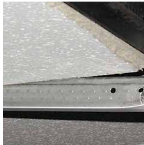
Les tés croisés non supportés permettent aux panneaux de tomber.
