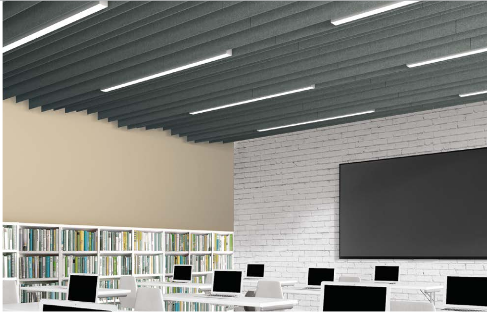
▲ Installation par crochet de la trousse de lames Vagues et Vogues FeltWorks avec un espacement de 8 po entre les lames
